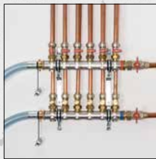
Preplachovanie radiátorov a plošných vykurovacích systémov (S/SL/SLW)
